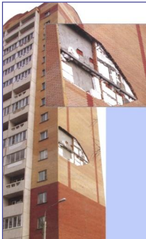
Рисунок . Обрушение фасада дома вследствие коррозии стальных гибких связей
