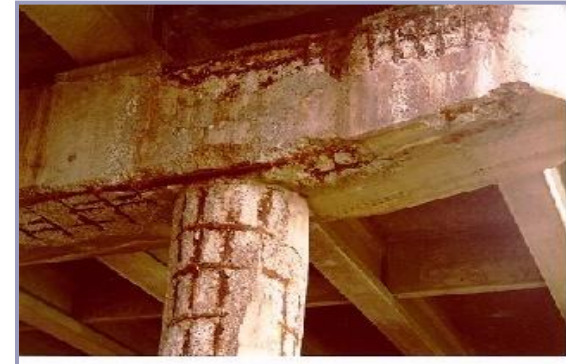
Рисунок . Разрушение опор моста
